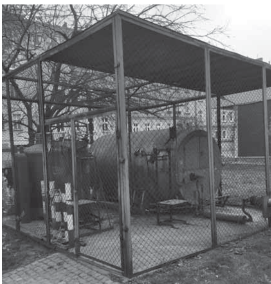
Wiata IFD z kontenerami ciekłego azotu – „spizarnia” LN2 wykorzystywana do dziś
